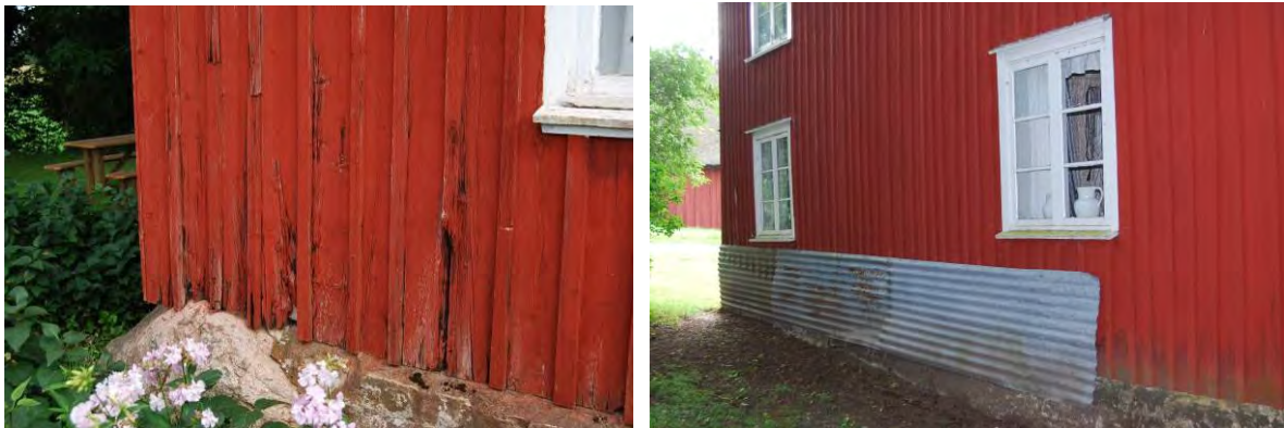
Skador på panelen på framsidan. Plåtar på baksidan. MOW
