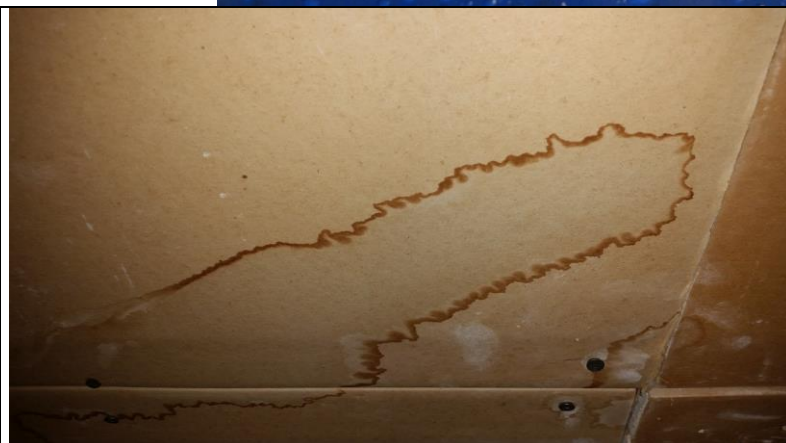
Gamla fuktskador i tak i omklädningsrum 04.
