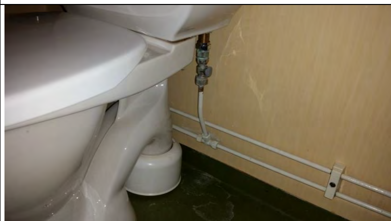
Misstänkt läckage från ventil till wc-stol i wc 70.
