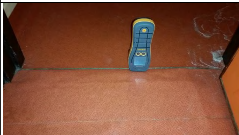
Formförändringar i golv kring wc 54 och förhöjda fuktvärden kan mätas.
