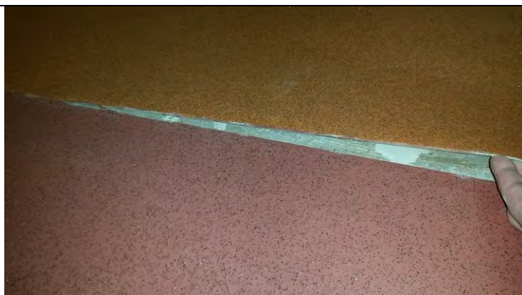
Tätskiktsskada i duschutrymme.
