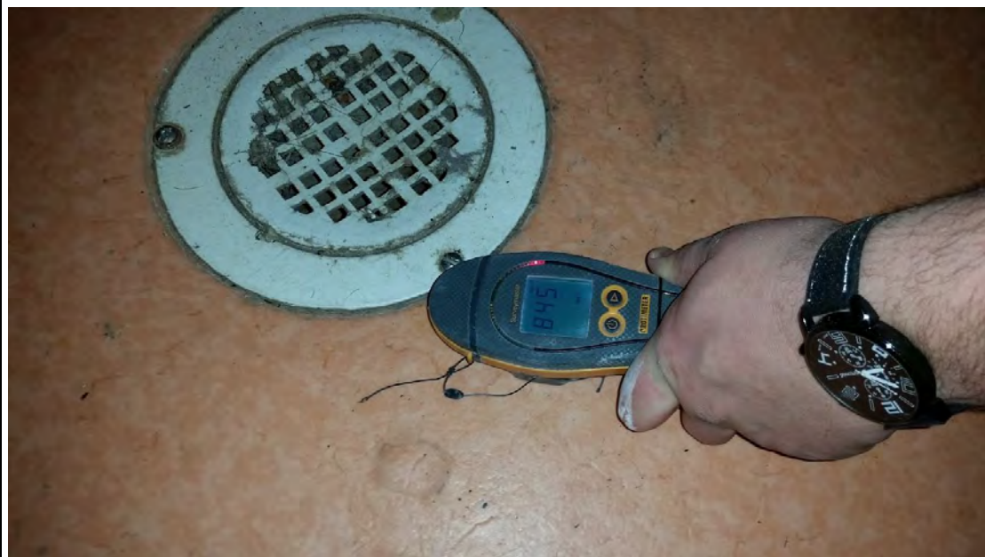
Förhöjd fuktighet i golv kring brunn i städrummet.
