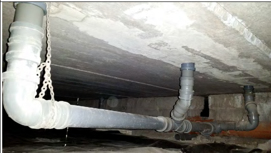
Fuktskador i betongvalv under duschutrymmen.
