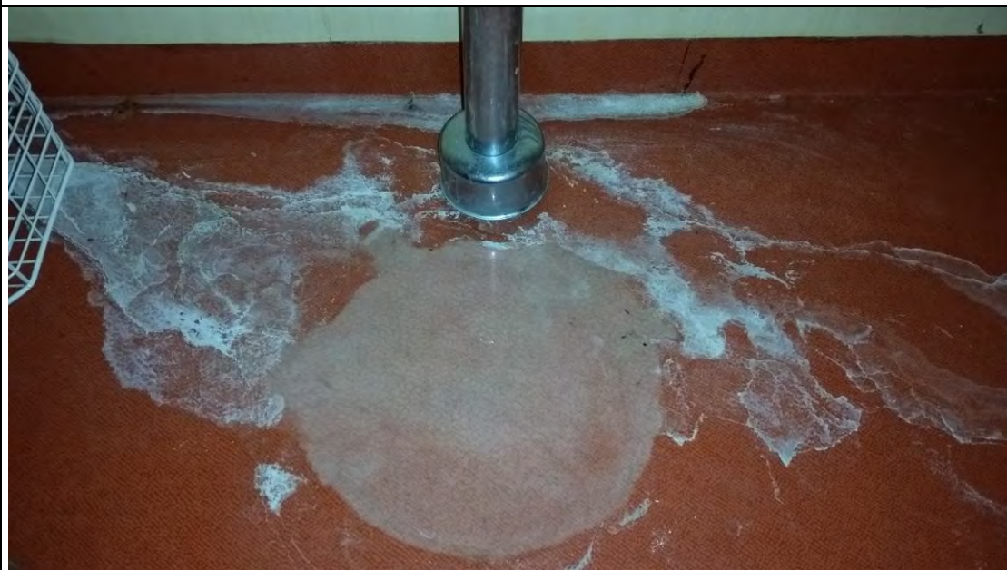
Fuktskada i WC 54.
