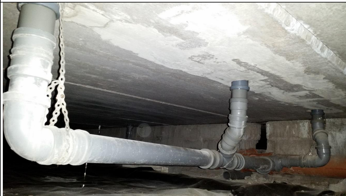
Fuktskador i betongvalv under duschutrymmen.
