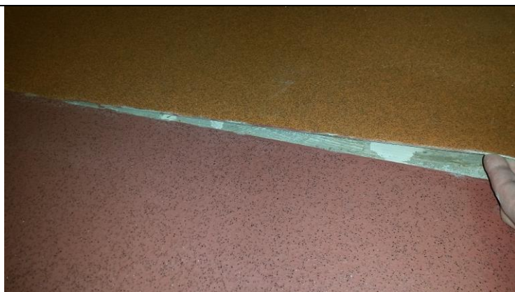
Tätskiktsskada i duschutrymme.
