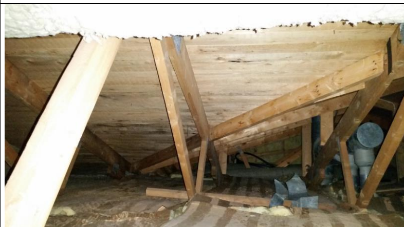
Lite mer mikrobiell påväxt på råsponten vid utstick mot övriga sektioner.
