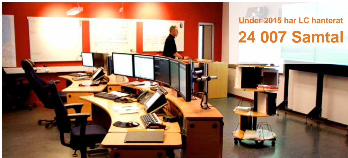
Ledningscentralen vid Norra Älvsborgs Räddningstjänstförbund. Foto: NÄRF
